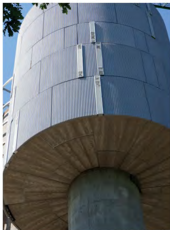
Nichoirs pour martinet noir intégrés à la paroi en béton du château d'eau © BIOMONITOR
