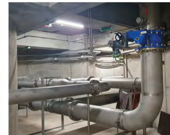
Conduite d'adduction sous une cuve © Luxplan
