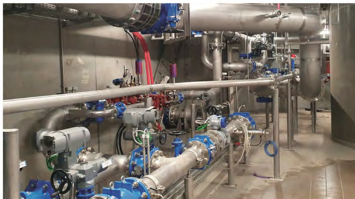
Labyrinthe de conduites au sous-sol © Luxplan
