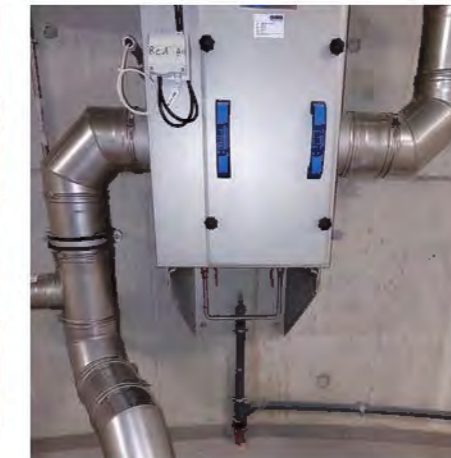
Filtre à air sur conduite de ventilation d'une cuve © Luxplan
