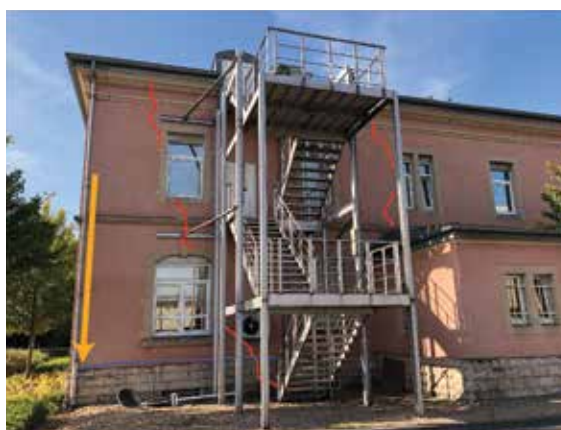
_Tassement pignon sud-est
