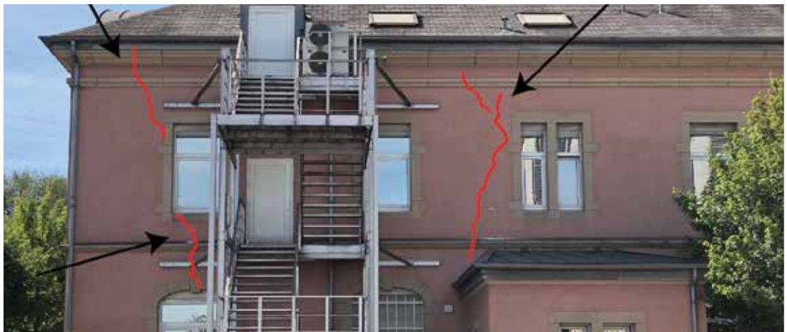
_Fissures sur la façade nord-est
