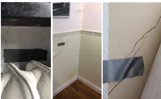
_Dégâts apparus sur les murs intérieurs
