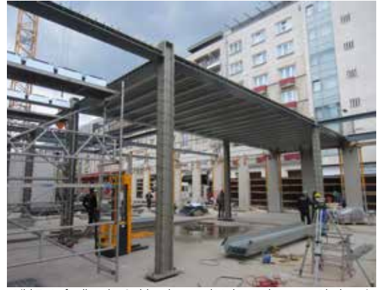
__Bild 7. Aufstellen der Stahlstruktur und Verlegen der ersten Bleche mit Hilfe von Rollgerüsten und Hubstapler (CR)
