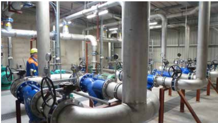
Figure 1 - Nouvelles installations de refroidissement (Eurofoil Dudelange)
