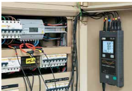
_Figure 5 - Campagnes de mesure électrique
