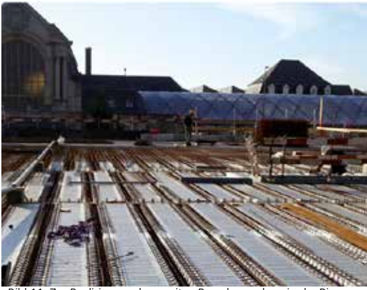
Bild 11. Zur Realisierung der zweiten Bewehrungslage in der Rippe werden gebogene Betonstahlmatten eingebaut
