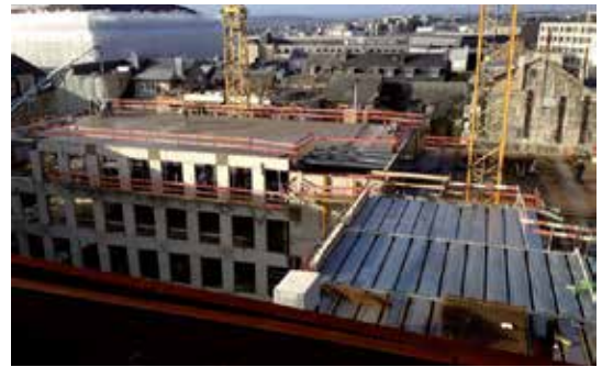
_Bild 14. Baustellenorganisation im Rohbau – Blechmontage, Bewehren und Betonieren der Abschnitt B, C und D
