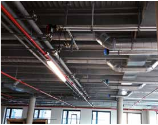
Bild 8. Kreuzungspunkte der Versorgungsleitungen werden in die Bereiche zwischen den Rippen der Decke gelegt, was zu einer flacheren Installationsebene und somit zu einer Reduktion der gesamten Höhe des Deckenaufbaus führt
