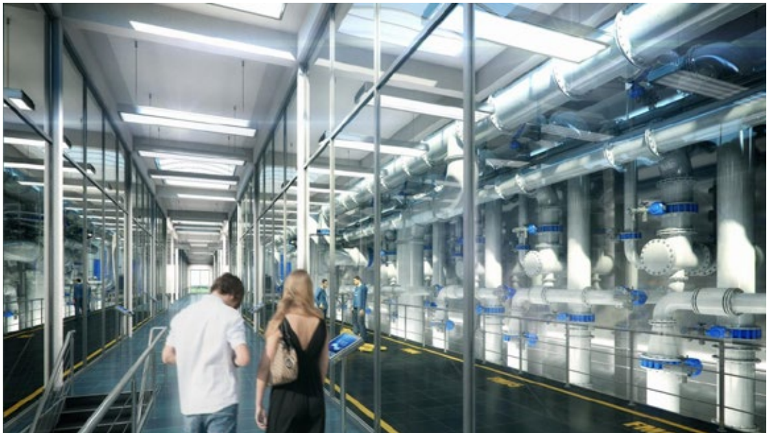
—Einsicht der wesentlichen verfahrenstechnischen Komponenten vom zentralen Besuchergang
