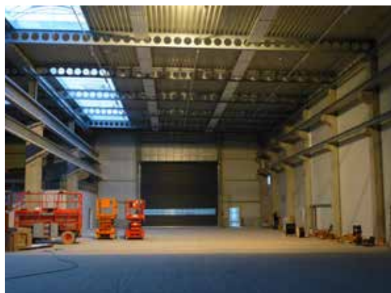
_ ACB®-Dachbinder und Kranbahnträger, Halle Hamburg
