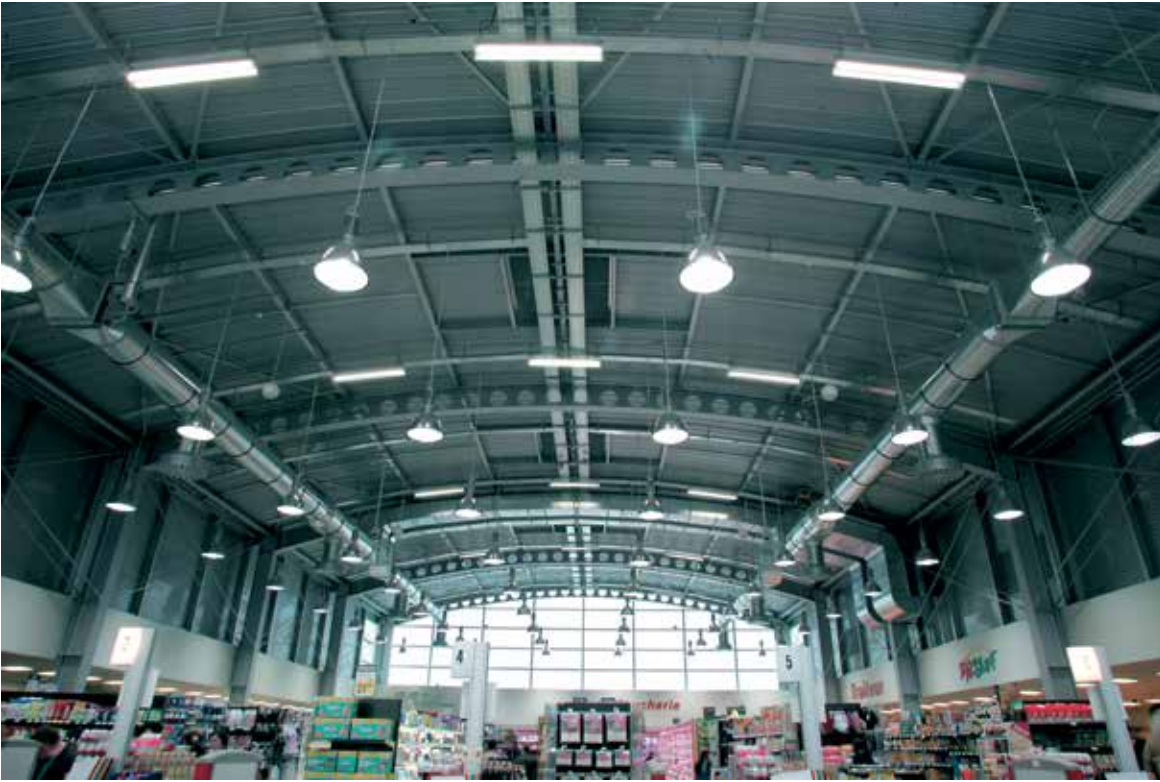
_Gekrümmter ACB®-Dachbinder in einem Supermarkt
